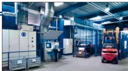
Delta-Beschichtungen sind im Werk MKS in Wetter seit langem erfolgreich im Einsatz. Jetzt wird diese Anlage erweitert.
